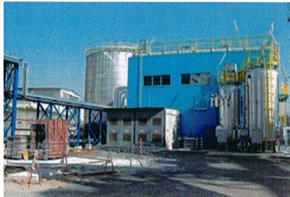
Una centrale per il teleriscaldamento (Immagine d'archivio)
